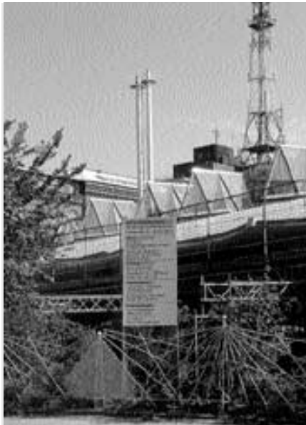
Eine unendliche Geschichte - das Dach der Sporthalle am Winterfeldtplatz
